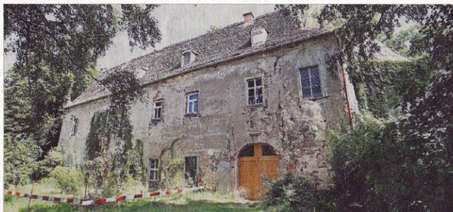
Das Dach des Westflügels ist eines der größten Sorgenkinder des Vereins.
